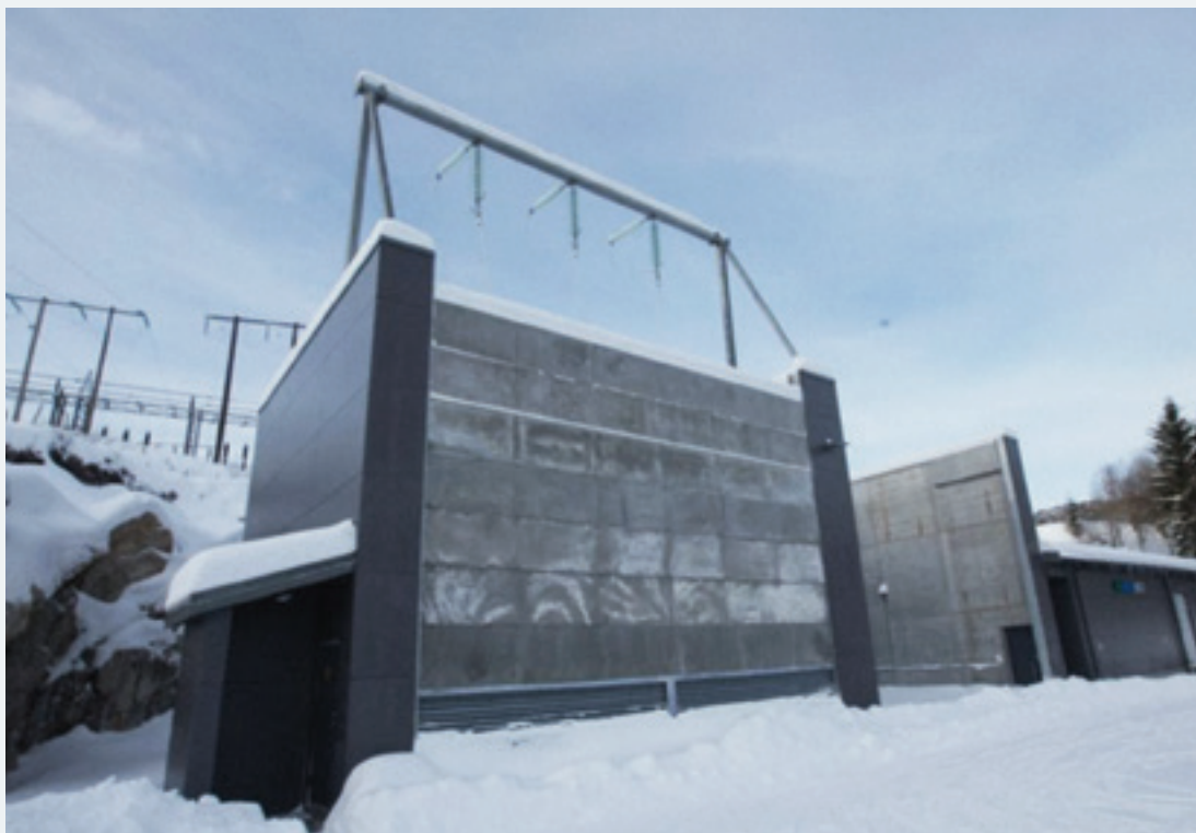
Årødal transformatorstasjon ferdigstilt i 2019.
